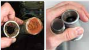
Sistema de tuberías
