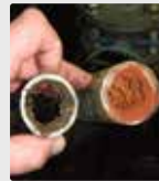
Sistema de tuberías
