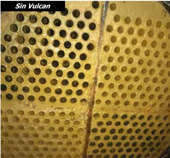
Antes de instalar Vulcan, las calcificaciones eran muy gruesas y duras en los tubos del intercambiador de calor.
