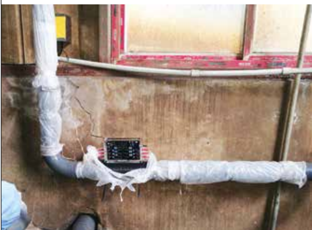
Vulcan S100 fue instalado en la sala de aguas residuales con el fin de tratar la máquina de deshidratación de lodos.
