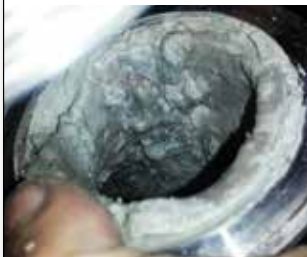
Antes de la instalación de Vulcan: la tubería estaba llena de incrustaciones.
