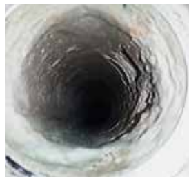
2 semanas después de la instalación de Vulcan, las incrustaciones se habían vuelto más blandas y se habían desprendido.
