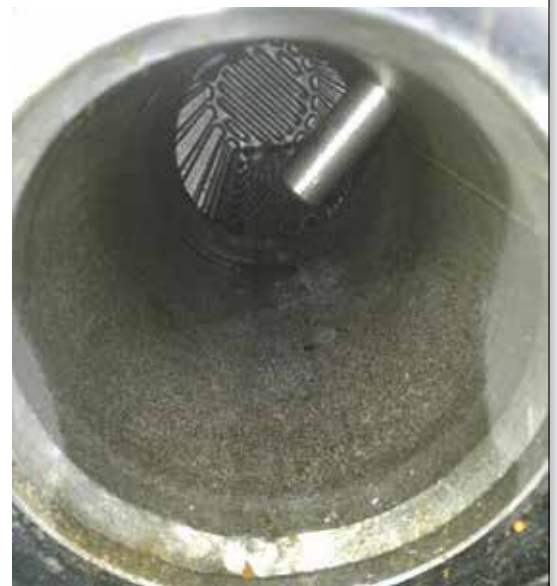
A los 3 meses: con Vulcan. Hasta ahora no ha habido necesidad de volver a limpiar las tuberías.
