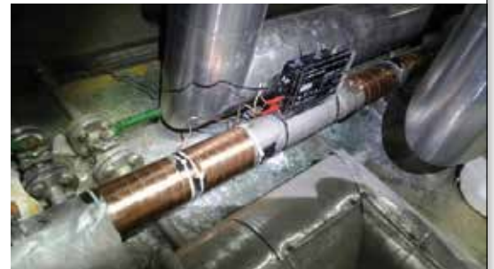
Vulcan S25 instalado en Toray Industries
