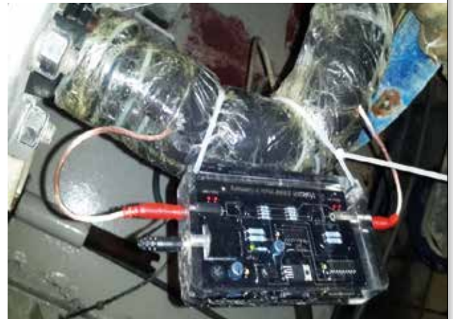
Vulcan 5000 se instaló en la entrada de agua del cuarto de reciclaje de agua.
